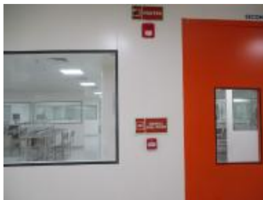
Fire alarm call point.JPG
